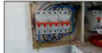
2. Cablejat presa terra sense connectar
