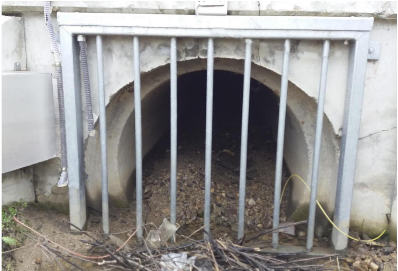
Figura 1.6. Protecció d'un drenatge per evitar accés de senglar a una zona amb tancament perimetral.
